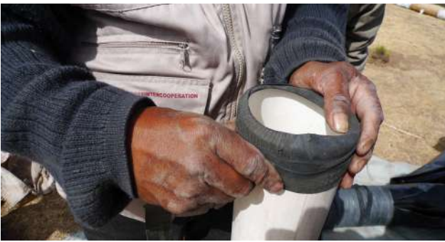
Figura 13: Ejemplos de protección de las tuberías: Arriba usando cinta adhesiva , y abajo usando liga de neumático.
