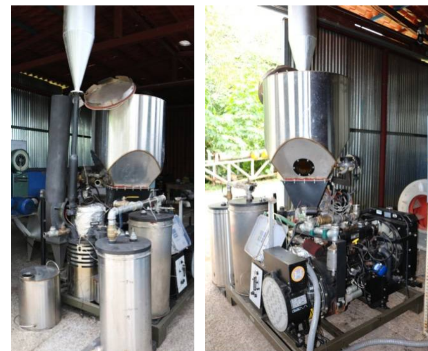
Figura 17. Gasificador para tratamiento de la pulpa y generador eléctrico con biogás
